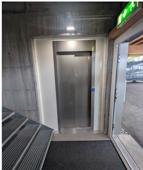
Homelift Mangusta installiert bei Kunde in Salmsach
